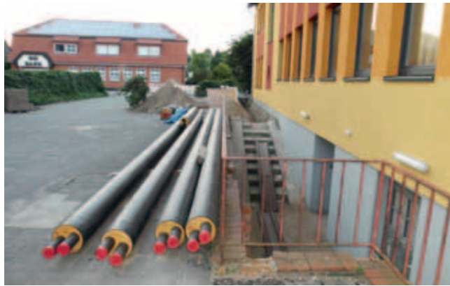
Wärmeleitungen an der Schule „Krummesse
