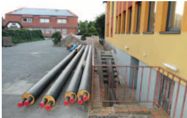
Wärmeleitungen an der Schule „Krummesse
